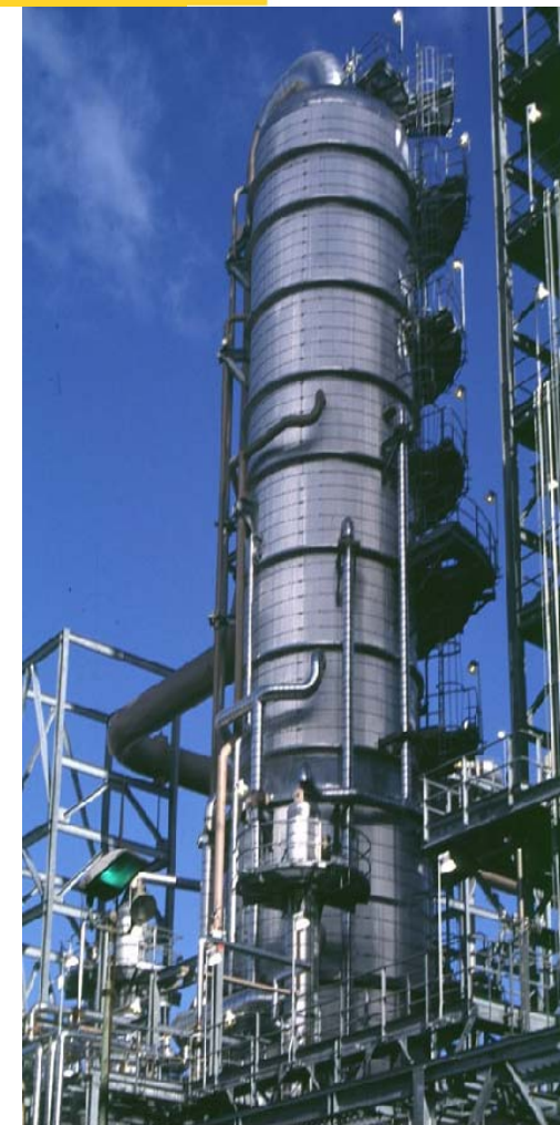
Ректификационная колонна установки АВТ
